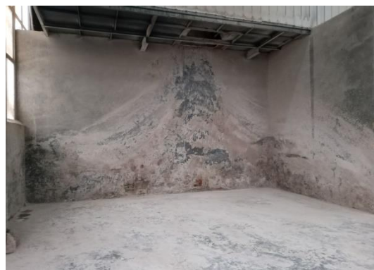
一次滤渣落料间
