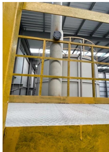
3#/4#除尘器排气筒及采样孔
